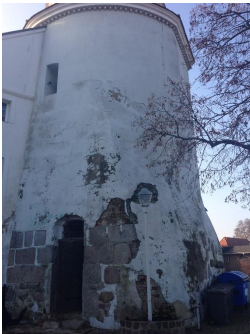
Vorher der Sanierung
